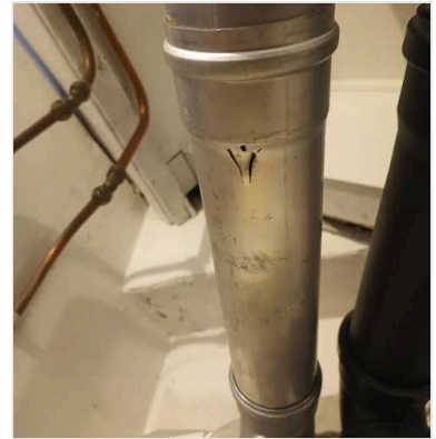
Opengescheurde naad in een aansluitleiding. Hier lekt rookgas de woning in.
