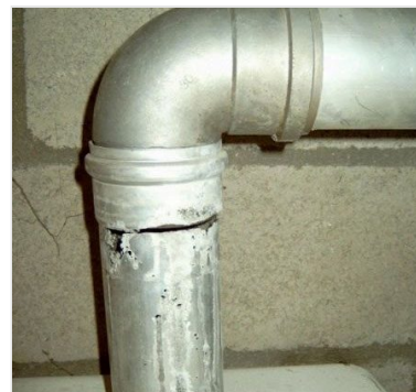
De werf: doorgevreten naad, vier jaar na de plaatsing.
